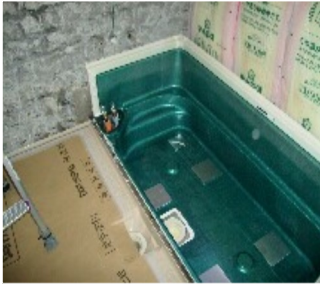
浴槽を包む断熱材
